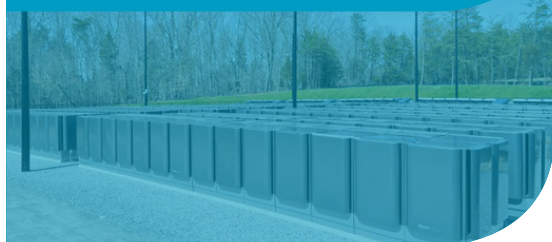
Datacenter Apple aux Etats-Unis avec pile à combustible
